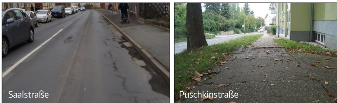
Abb. 4 Oberflächendefizite im betrachteten Straßennetz
