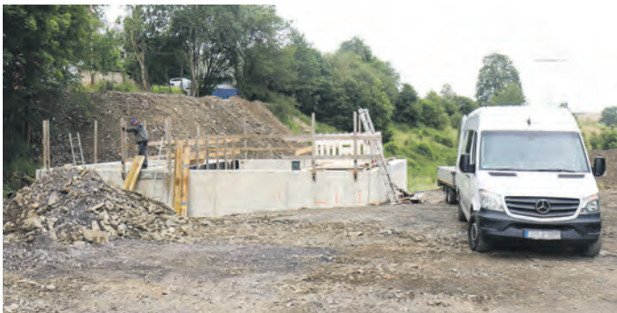
Herzstück der Abwasserentsorgung ist die neue Kläranlage in Dorfilm.
