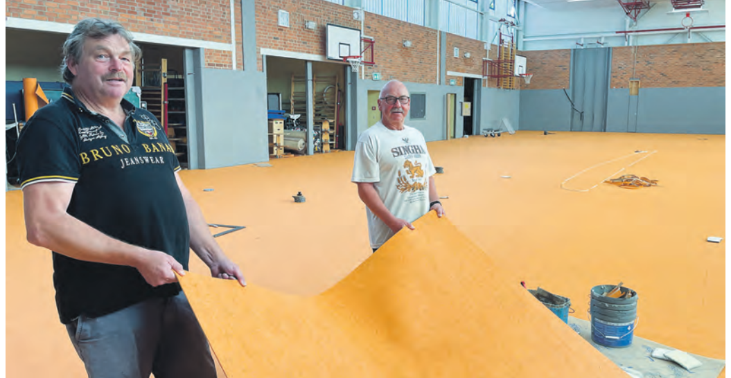
Thomas Wagner (links) und Michael Holz auf der Heide von der Firma Wagner Sportbodenbau verlegen am den neuen Belag in der Dreifeldhalle Trommsdorffstraße. (Foto: Peter Lahann)
