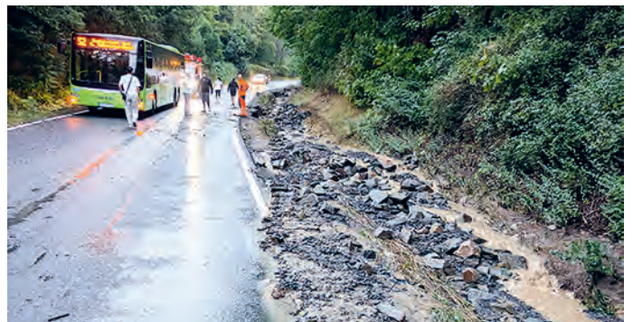
Die K 183 zwischen Unterwirbach und Bad Blankenburg ist erneut von Starkregen in Mitleidenschaft gezogen worden. (Foto: SG Tiefbau)
